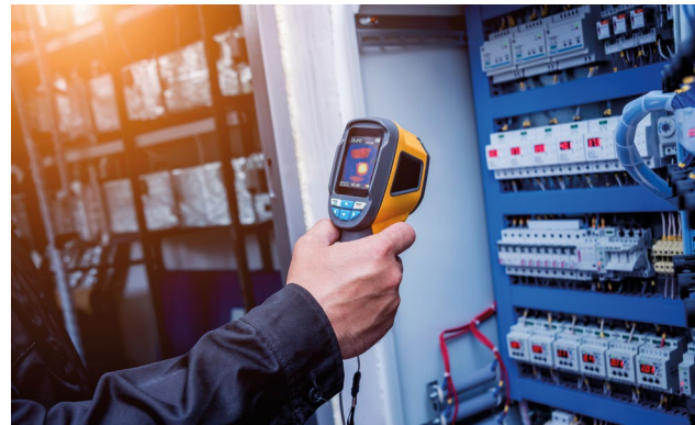
Thermische Überlastung durch Oberwelle
